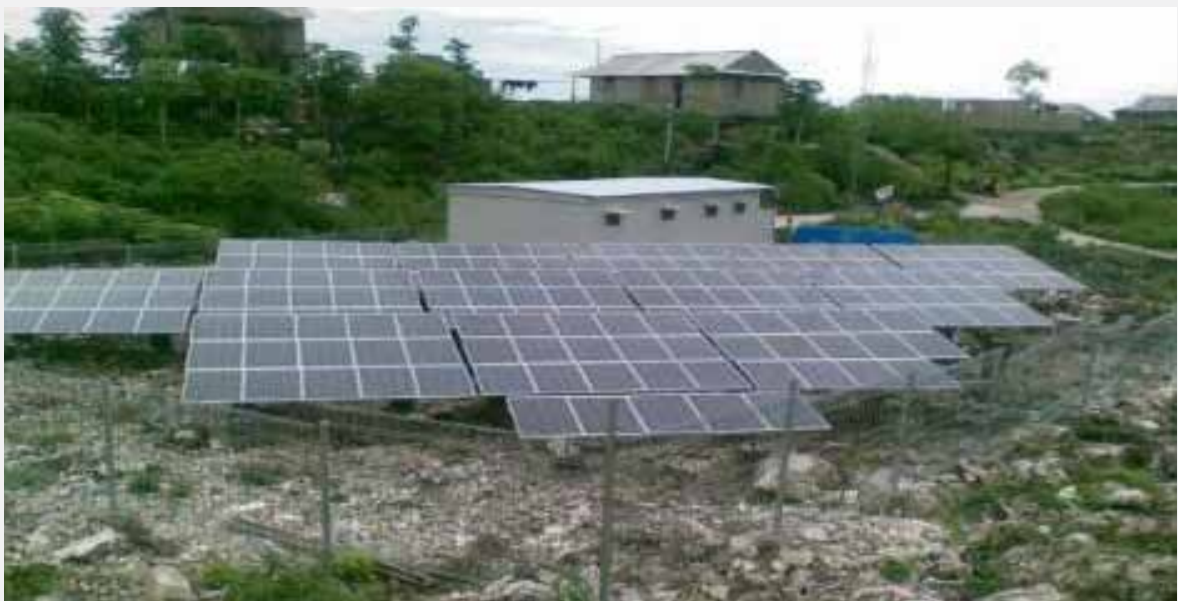
instalasi PLTS proyek ESDM
