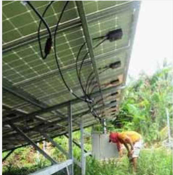
instalasi PLTS di Maluku Utara
